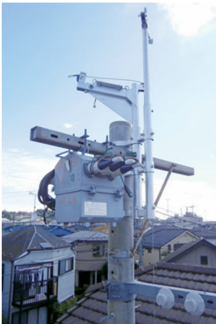
P.A.S手動昇降装置設置状況
