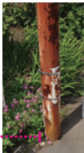
信号灯腐食状況
