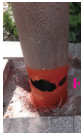
歩道灯腐食状況
